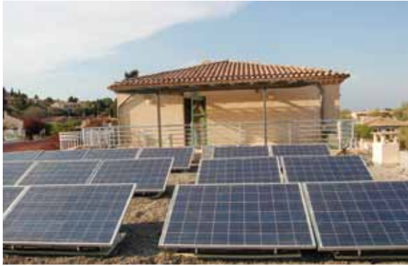
Des panneaux solaires installés à Venelles Solar panels installed at Venelles
